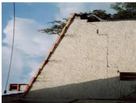
Fig 1.7 : Fissures au niveau d'une structure de génie civil.
