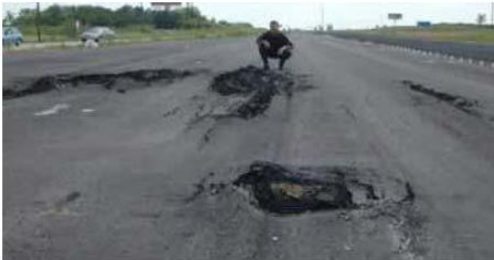
Fig 1.8 : Déformation d'une chaussée de sol instable.
